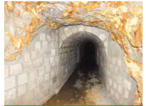
Beton idomkövel megerősített vágatszakasz a Béke-táróban (Fotó: Holló Sándor)
